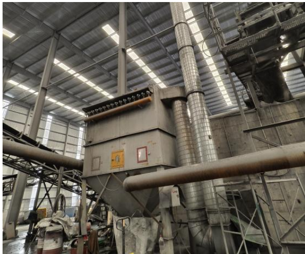
旋风+布袋除尘器+排气筒
