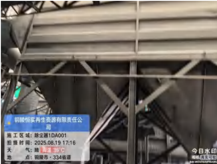
图 3.1.2-1 高效除尘器（TA001）
